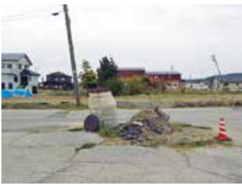
▲地震により液状化のため隆起したマンホール（珠洲市）
