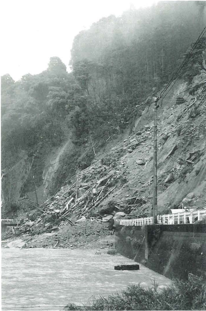
6月18日午後、安田町与床の県道安田東洋線沿いの山側斜面が大規模に崩壊のため全面通行止めとなる
