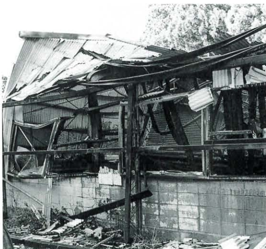
全燃した木材製品倉庫
