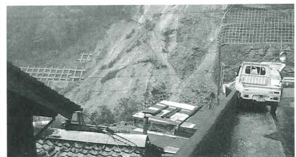
9月19日 県道「安田東洋線」改良工事現場で土砂崩れ
