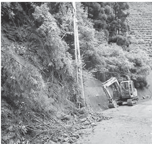
▲平成23年5月 県道安田東洋線山側崩壊
